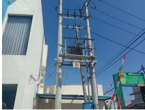
Gambar 2. Kondisi Trafo PLN.
