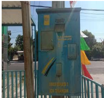
Gambar 3. Kondisi Meter PLN.
